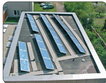
Bild 3: Äußerer Blitzschutz an PV-Anlage
