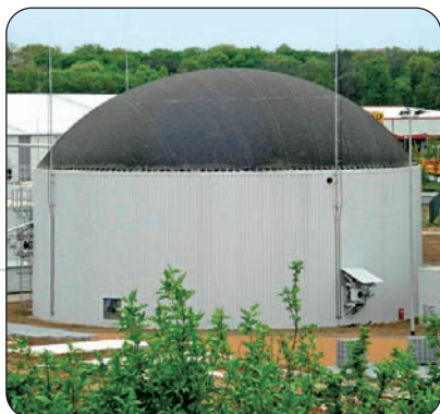
Bild 2: Äußerer Blitzschutz an einer Biogasanlage
